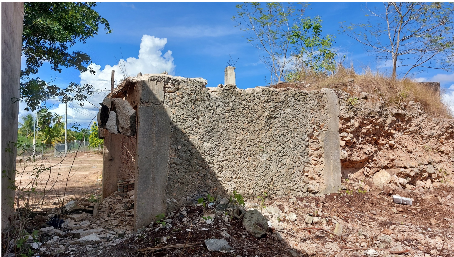
Ilustración 15 Construcción existente derrumbada
