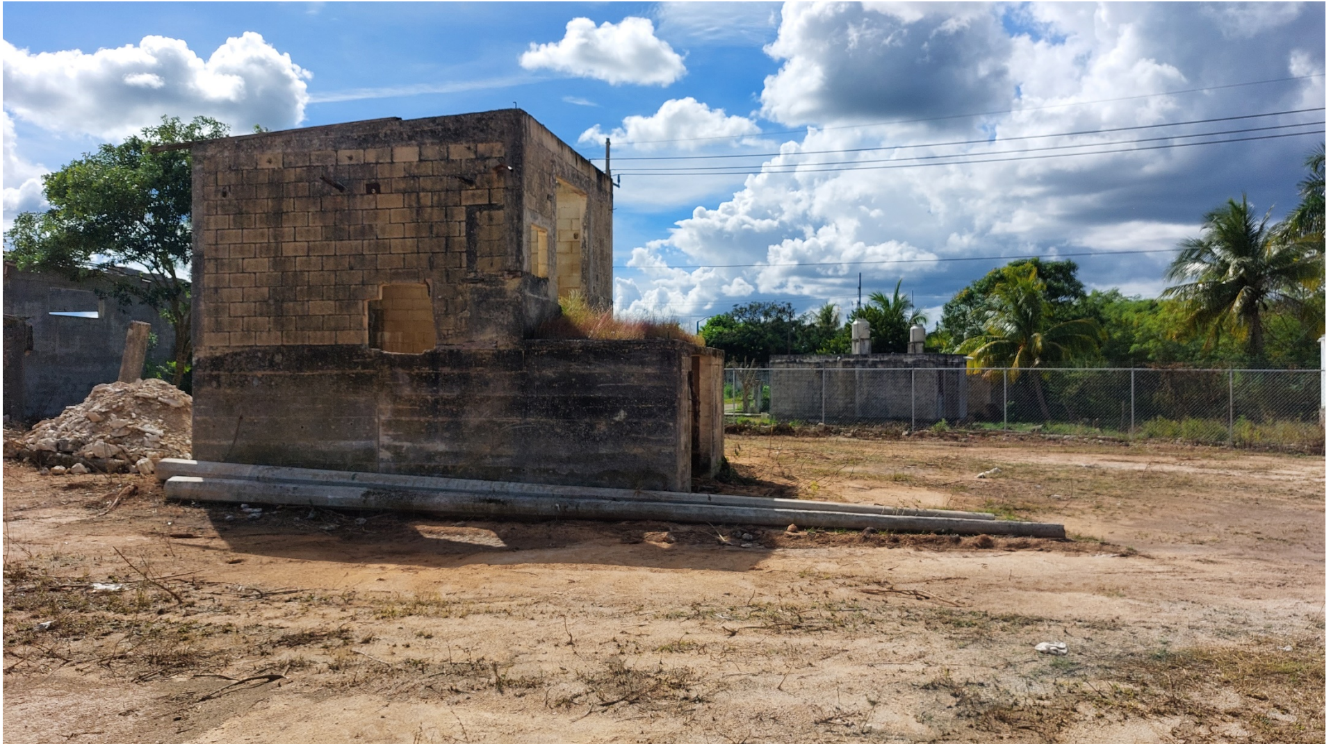
Ilustración 14 Construcciones existentes en el predio ya con los techos derrumbados
