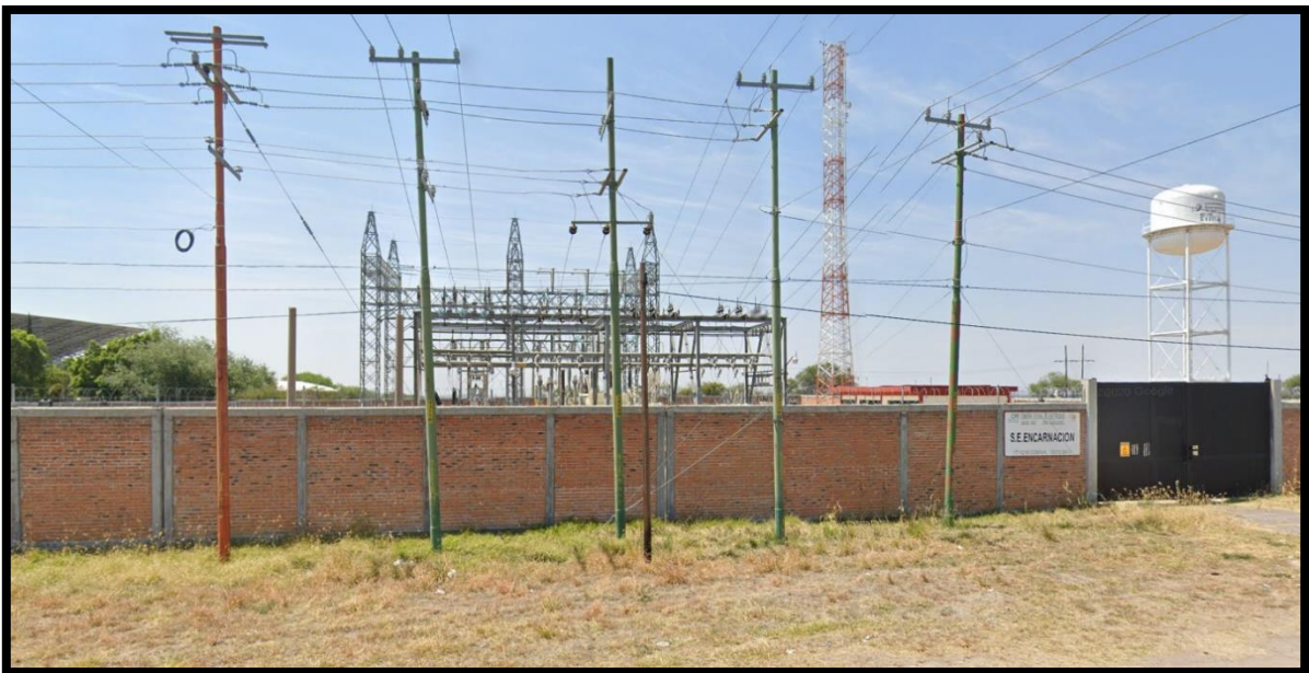
FOTOGRAFÍA 2. SUBESTACIÓN ELÉCTRICA DE LA COMISIÓN FEDERAL DE ELECTRICIDAD CFE A 109 METROS LINEALES APROX. AL OESTE.
