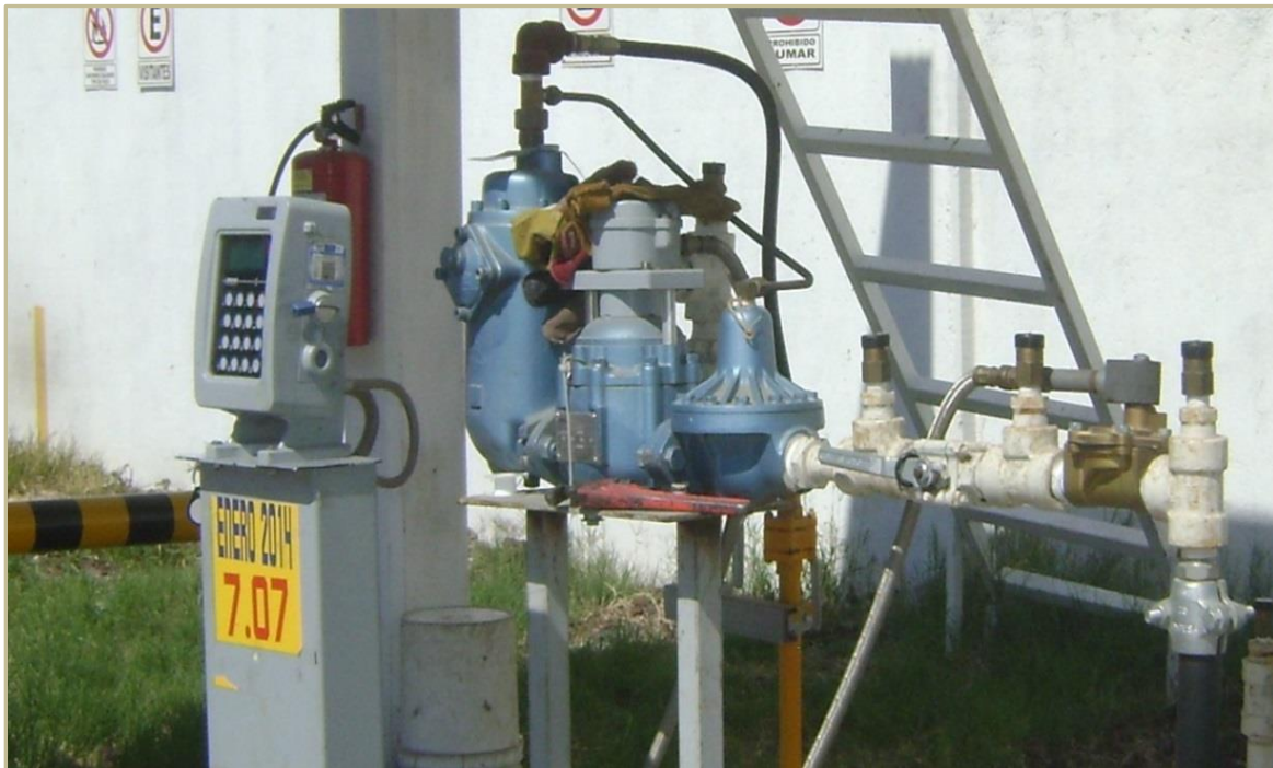
Figura III.1.c)-1. Dispensario doble para el Gas L.P.
