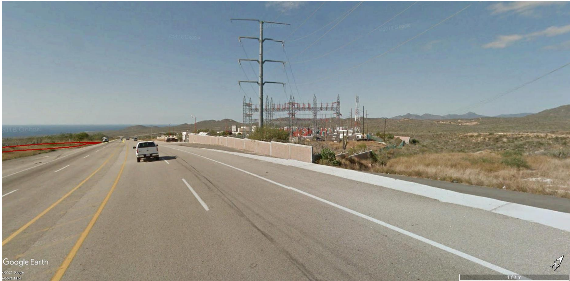
PANORÁMICA DE LA CENTRAL TURBOGAS LOS CABOS DESDE SU EXTREMO SUR. (VISTA DESDE LA CARRETERA CABO SAN LUCAS – TODOS LOS SANTOS)
