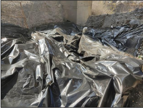
17. Colocación de filtros de carbón activado, en el Área Afectada por la Gasolina derramada.
