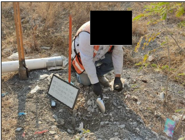
9. Toma de muestra en la periferia del Área Afectada.
