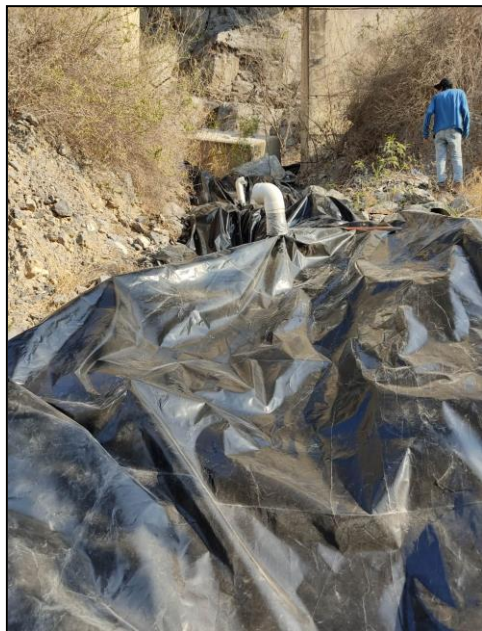
15. El sitio afectado por el derrame de Gasolina fue cubierto con una membrana de polietileno alta densidad.
