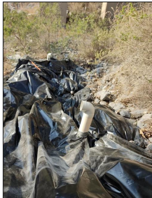
16. Se colocaron filtros de carbón activado, con la finalidad de captar los COV's.
