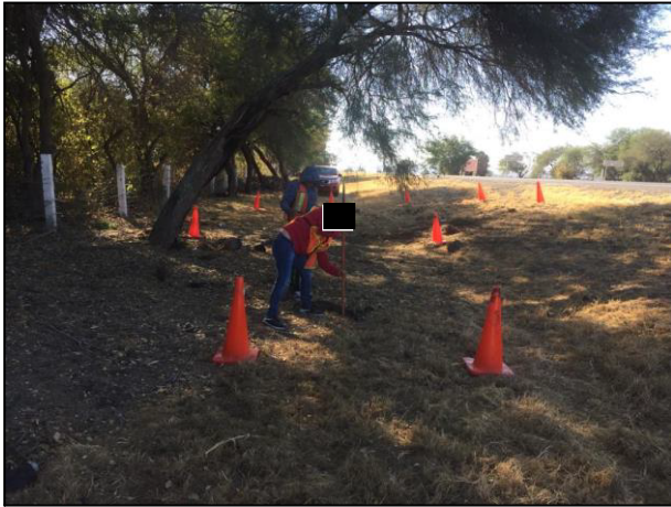
01. En el sitio se realizaron pozos para la colocación de filtros de carbón activado.
