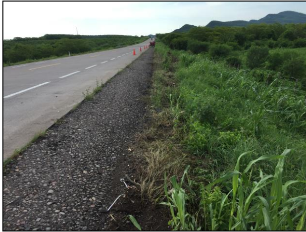
1 - El sitio de derrame se encuentra ubicado en el Km. 234 de la Carretera Federal No. 15-D Tepic - Mazatlán, a la altura del poblado de Villa Unión, Mazatlán, Sinaloa.
