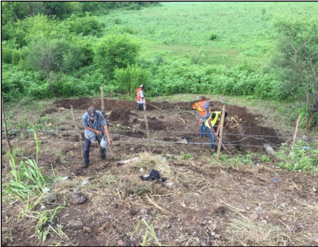
1 - Con apoyo de recurso humano, se instaló la cerca perimetral afectada por el accidente, así como también se iniciaron las labores de emergencia.
