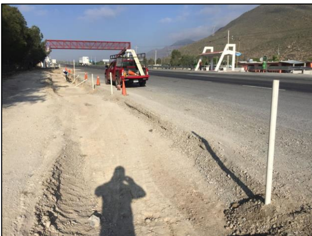
17 - Zonas de Extracción derivadas de las Labores antes descritas. Además, se realizó la colocación de tubos de prevención vial.
