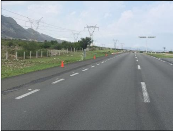
01 - Por seguridad, el sitio en estudio fue señalizado con equipo de seguridad vial, delimitando a su vez el área de trabajo.
