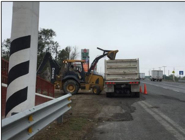
15 - Colocación del material edáfico afectado en camión de volteo para su acarreo hacia la Celda Provisional.
