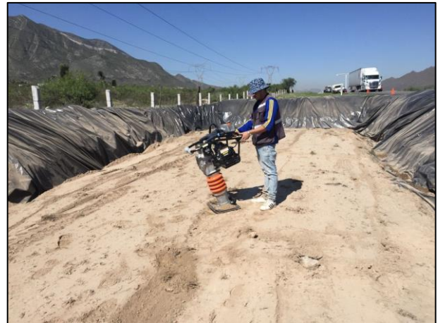
10 - Con apoyo de una compactadora manual, se realizó la compactación de la segunda capa de arcilla.
