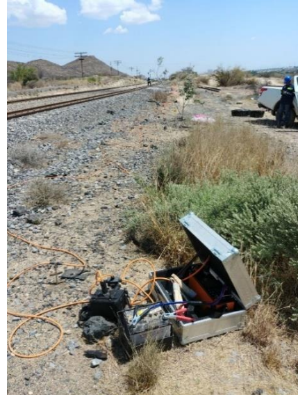
Figura 5.38. Conexiones para la operación del equipo
