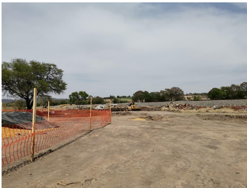
Figura 7-1.- Delimitación de zonas de trabajo con malla de polietileno naranja con postes de madera
