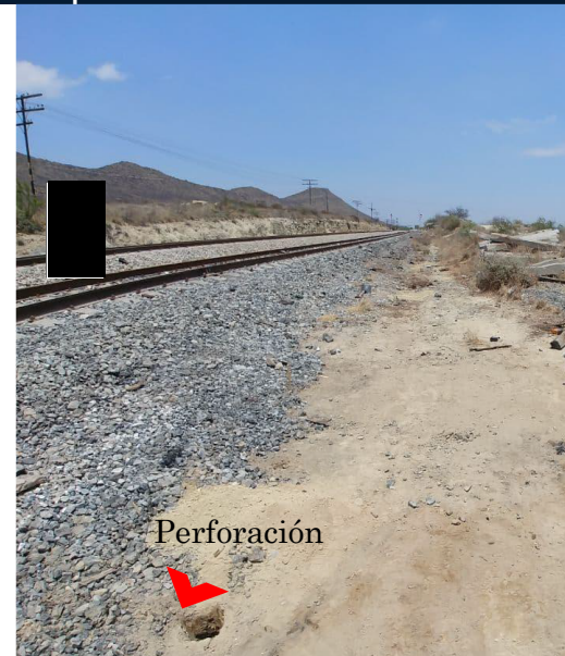
Figura 4. Evidencia de perforaciones en área de vías
