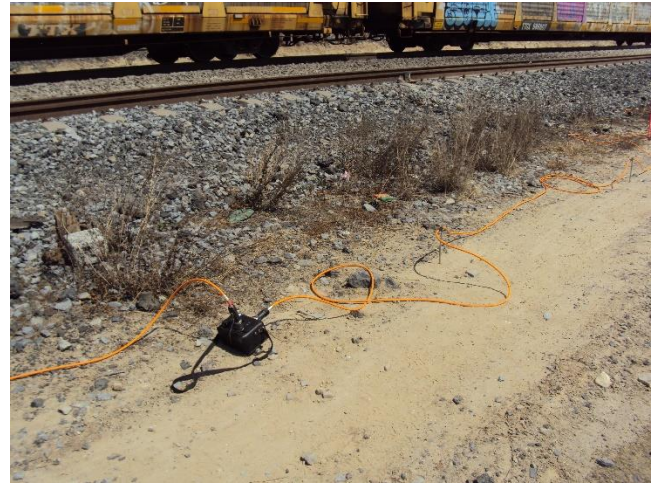
Figura 29. Conexión de cables y electrodos
