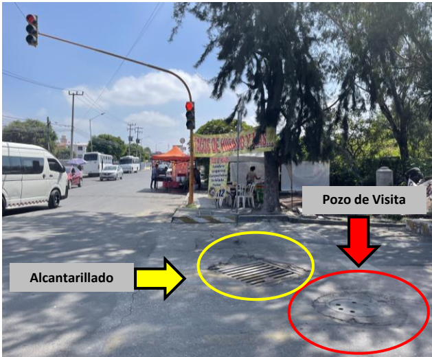
Foto 16- Pozo de visita y alcantarillado sobre Blvd. De Las Flores.
