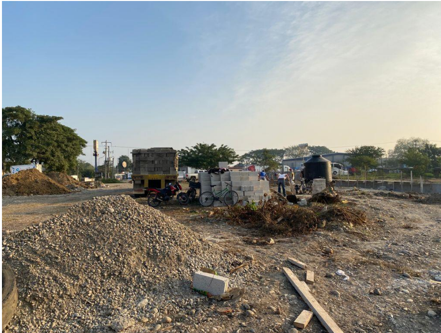
Imagen 9. En la colindancia sur del predio hay material de construcción disperso.
