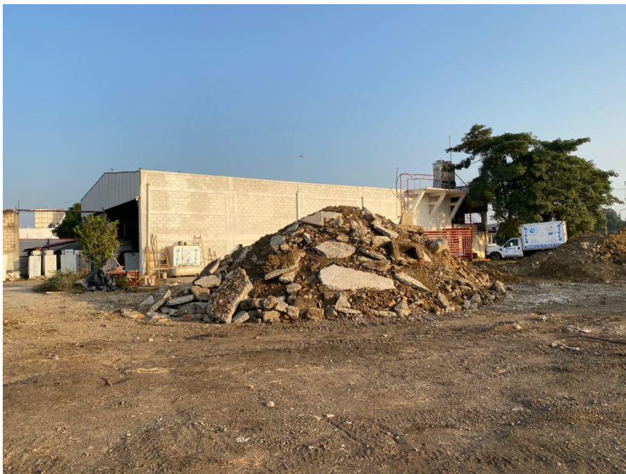
Imagen 4. En la zona central del predio existe escombros depositados por algunos vehículos pesados.
