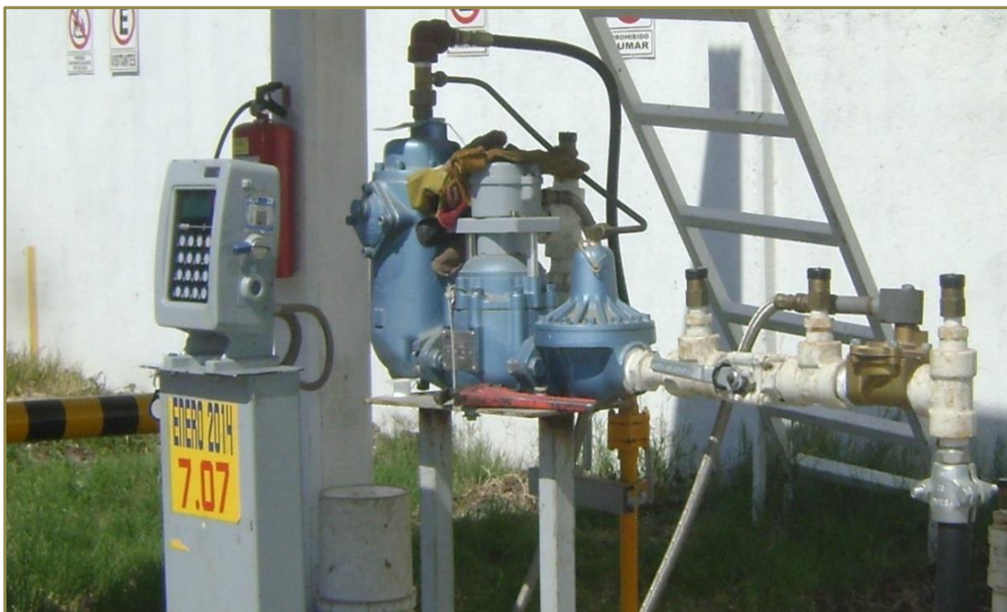
Figura III.1.c)-1. Dispensario doble para el Gas L.P.
