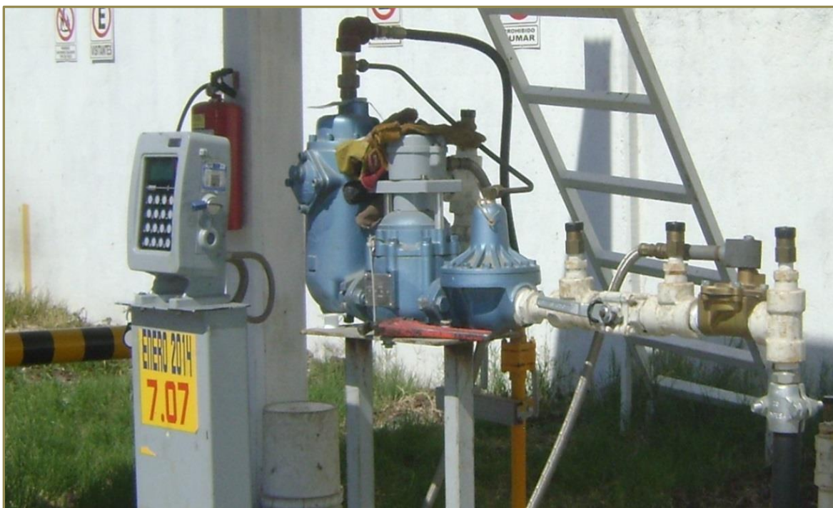
Figura III.1.c)-1. Dispensario doble para el Gas L.P.
