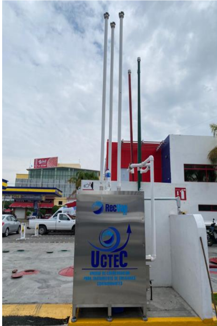
Figura 9 Unidad de Condensación para el tratamiento de emisiones contaminantes
