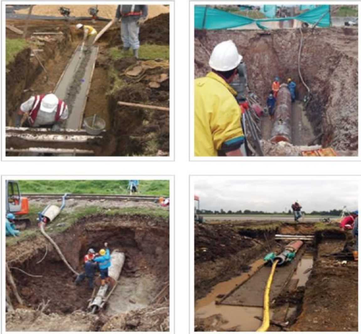
Figura I-9. Proceso de instalación de tubería: perforación e hinca de tubería por golpeo o apisonamiento (pipe ramming)
