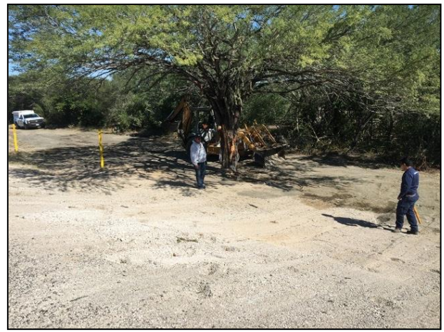
03. Al momento de la Visita Inicial se observó afectación en derecho de vía.
