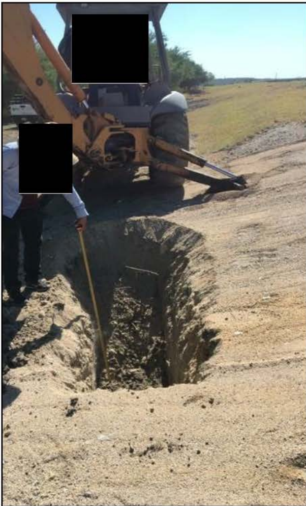
08. Con ayuda de flexómetro se corroboró el desplazamiento vertical del hidrocarburo derramado.
