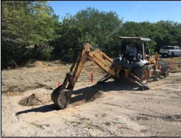
06. Sondeos realizados en sitio para corroborar la infiltración del hidrocarburo derramado.
