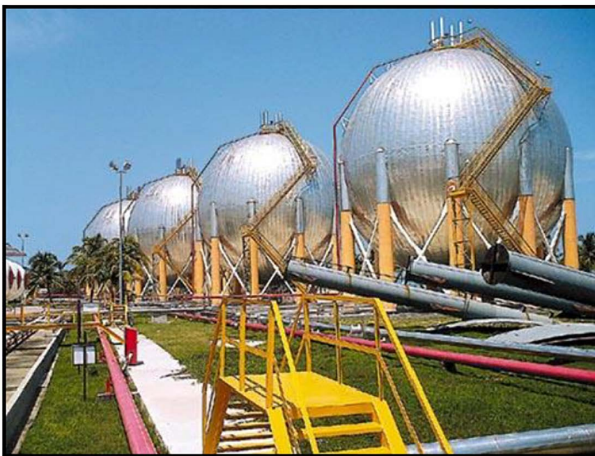
Figura II.7. Esferas de Almacenamiento de Gas L. P.
