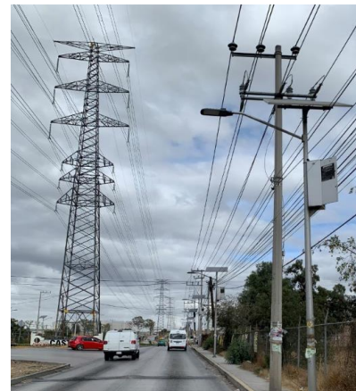
Foto 12- Líneas de Transmisión eléctrica sobre Libramiento Norte.
