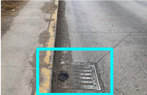
Foto 5- Boca de tormenta para aguas pluviales sobre Libramiento Norte.
