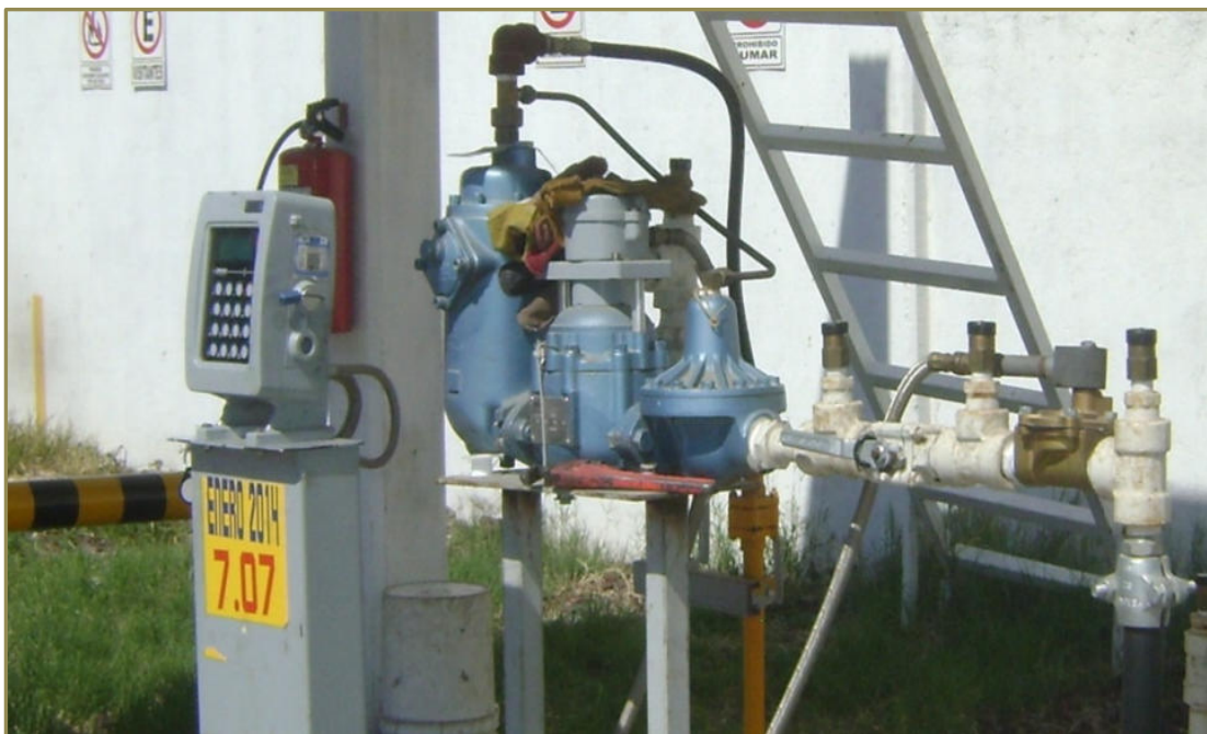
Figura III.1.c)-1. Dispensario doble para el Gas L.P.
