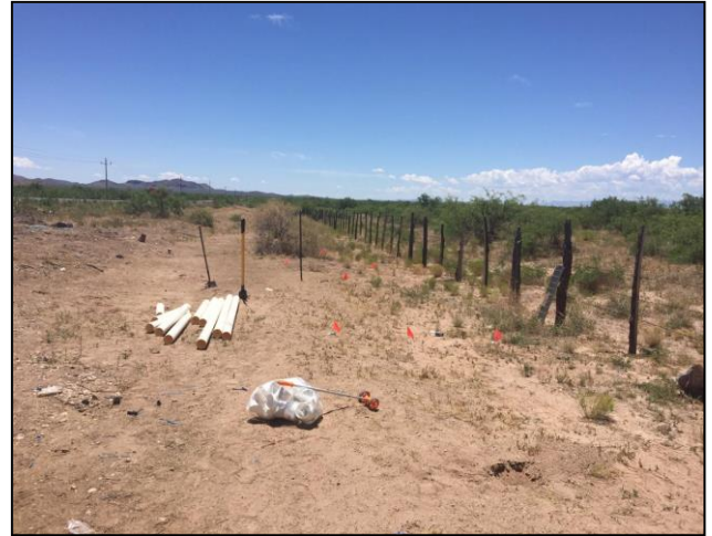
2. Señalización de fibra óptica.
