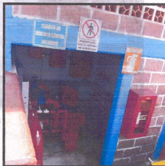
Cisterna y cuarto de bombas contra incendio
