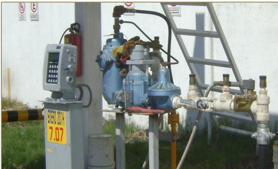
Figura III.1.c)-1. Dispensario doble para el Gas L.P.
