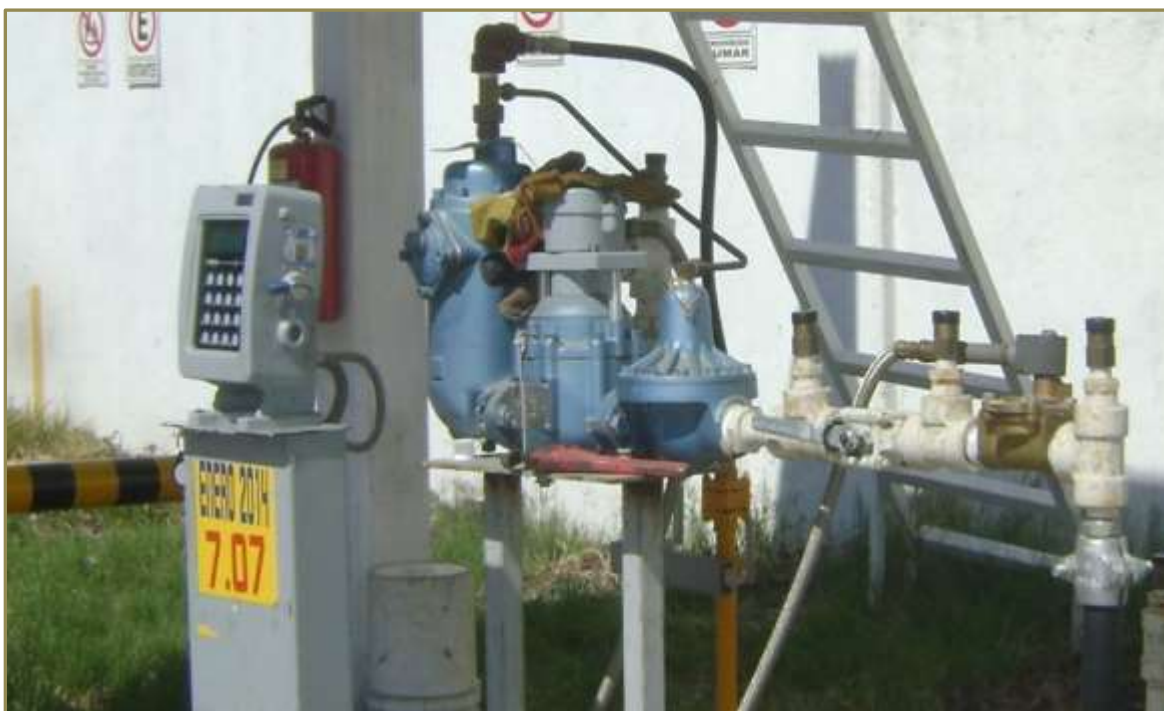
Figura III.1.c)-1. Dispensario doble para el Gas L.P.
