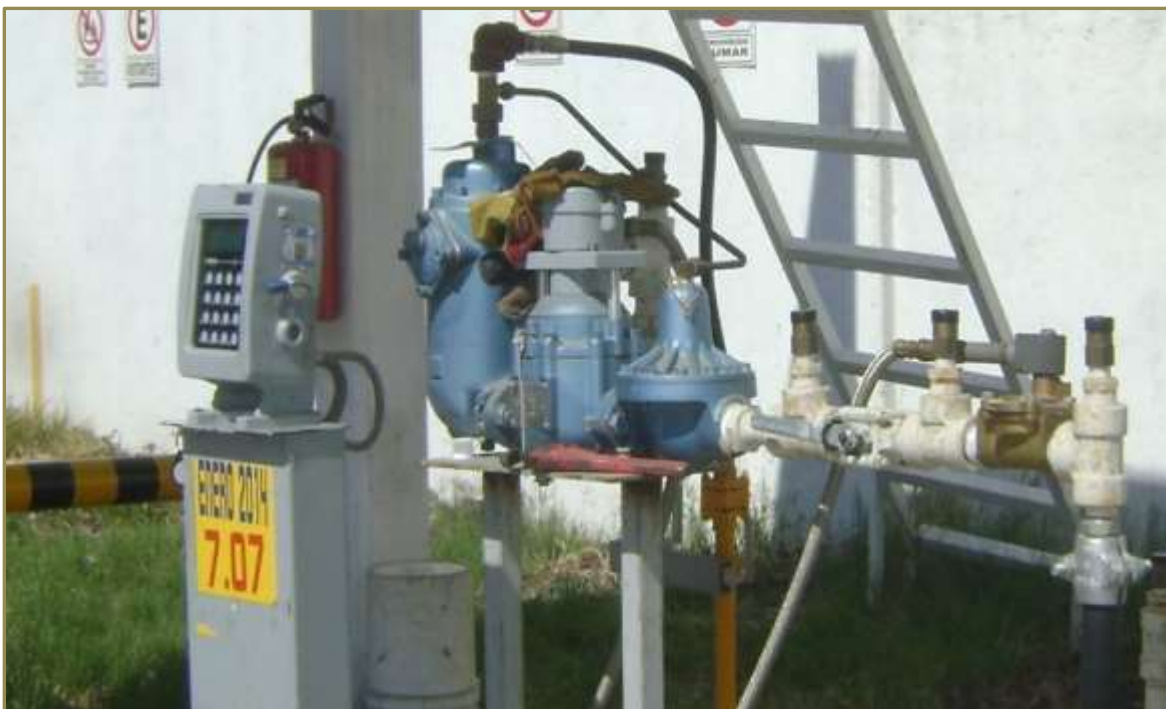
Figura III.1.c)-1. Dispensario doble para el Gas L.P.
