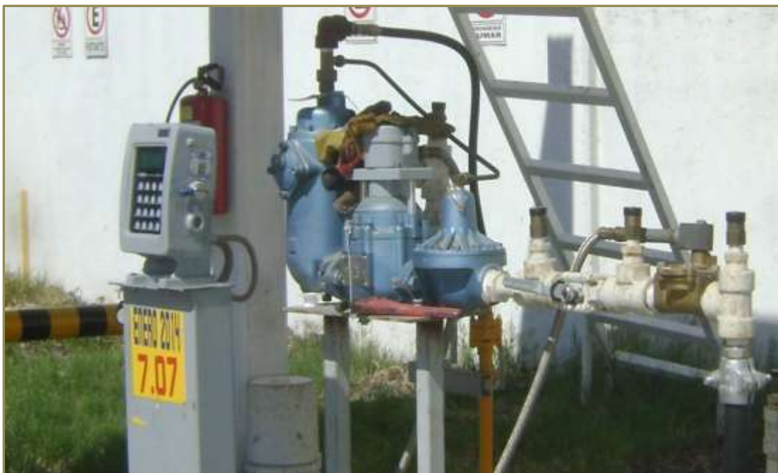
Figura III.1.c)-1. Dispensario doble para el Gas L.P.
