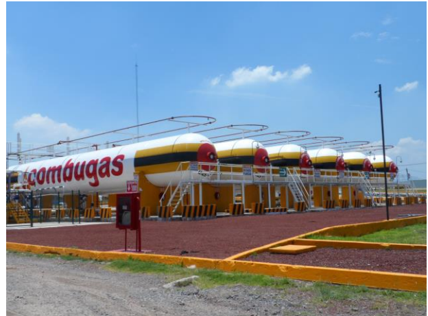
Figura 59. Tubería de rociado en cada tanque, con boquillas aspersoras
