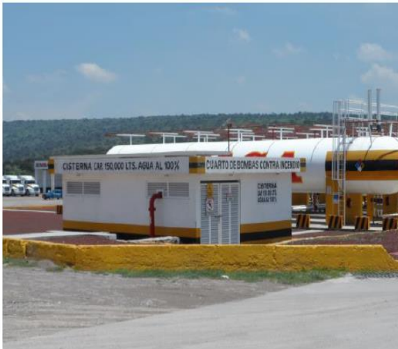
Figura 16. Cuarto de bombas
