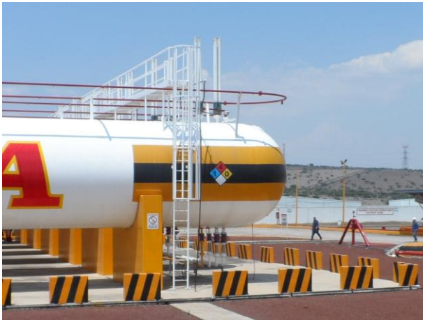
Figura 65. Válvulas de seguridad ubicadas en el lomo de los tanques de almacenamiento
