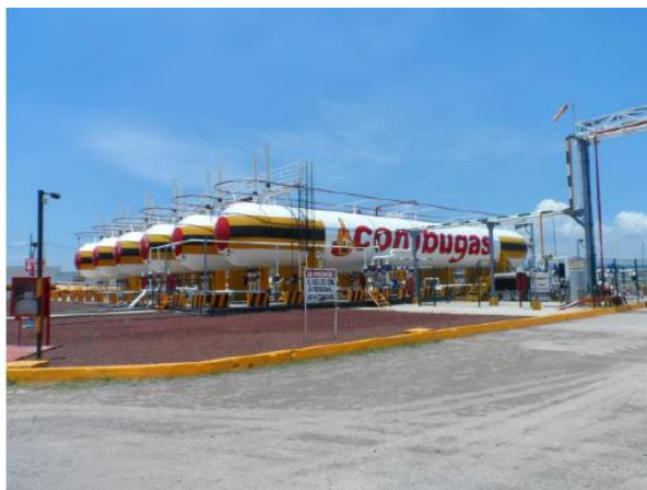
Figura 56. Tanques de almacenamiento de Gas L.P. (Vista lateral)
