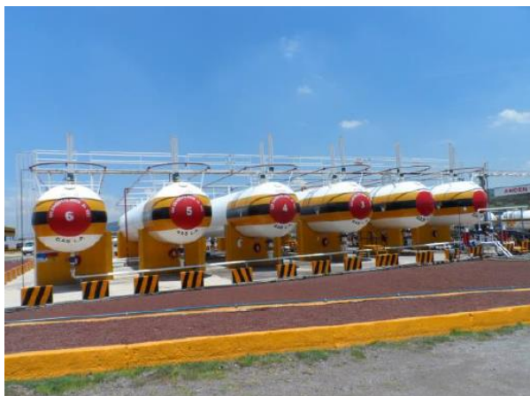
Figura 55. Tanques de almacenamiento de Gas L.P. (Vista frontal)
