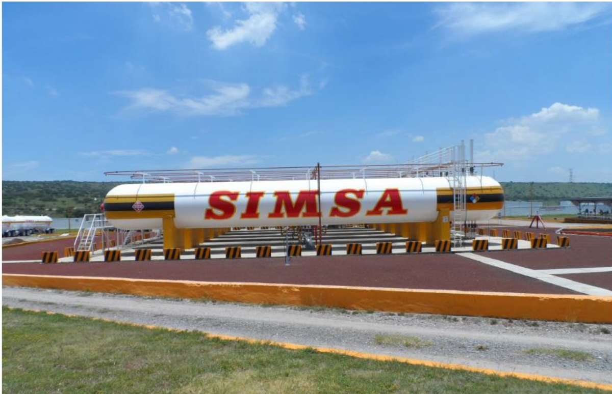
Figura 18. Vista lateral del área de almacenamiento de Gas L.P.
