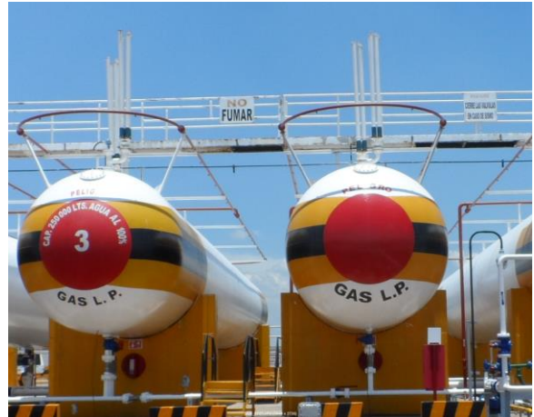
Figura 66. Válvulas de seguridad ubicadas en el lomo de los tanques de almacenamiento
