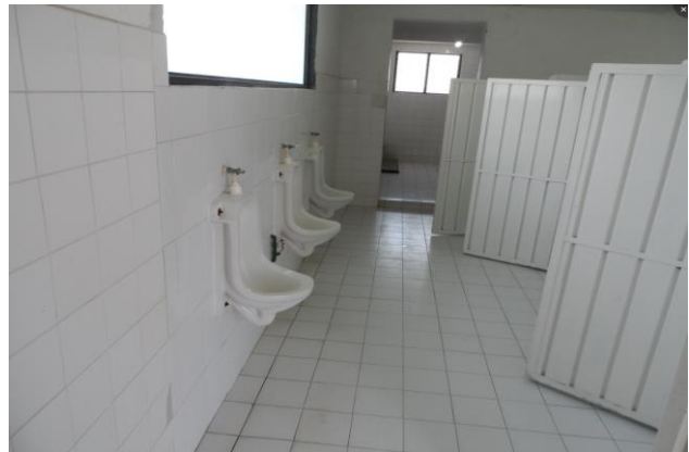
Figura 50. Servicios sanitarios para operadores de autotanques y semirremolques
