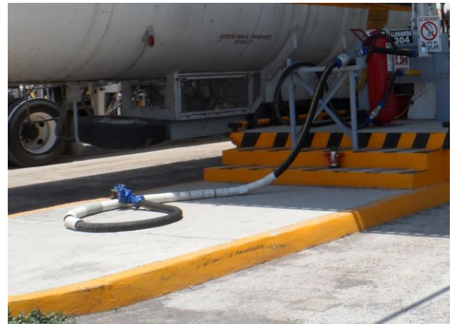
Figura 68. Manguera de descarga en el andén de carga y suministro de semirremolques
