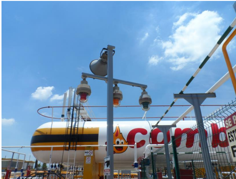
Figura 61. Alarmas sonoras y visuales del área de tanques de almacenamiento de gas L.P.
