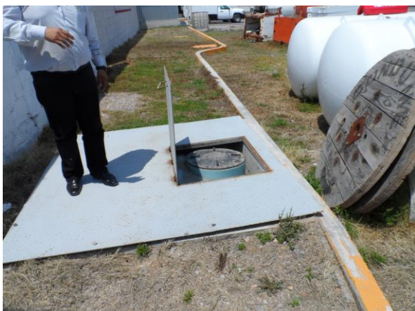
Figura 69. Trampa de combustibles y aceites
