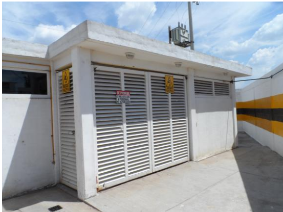
Figura 53. Subestación eléctrica y poste con el transformador
