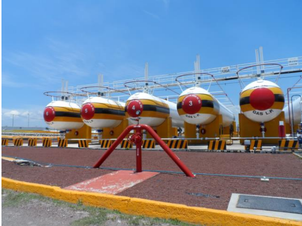
Figura 58. Tubería de rociado en cada tanque, con boquillas aspersoras
