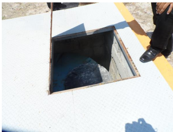
Figura 70. Trampa de combustibles y aceites
