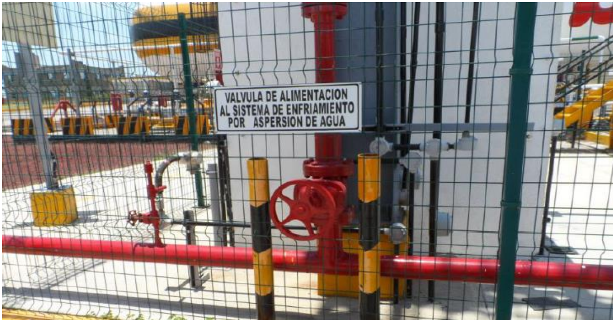
Figura 57. Válvula de alimentación sistema contra incendios en el área de tanques de almacenamiento de Gas L.P.
