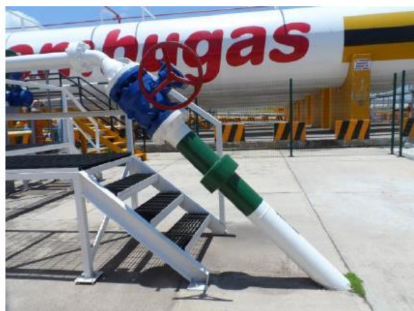
Figura 28. Patín de recibo y medición. Junta monoblock (color verde) y válvula de corte con maneral (azul), a la salida del gasoducto de 6" de diámetro
