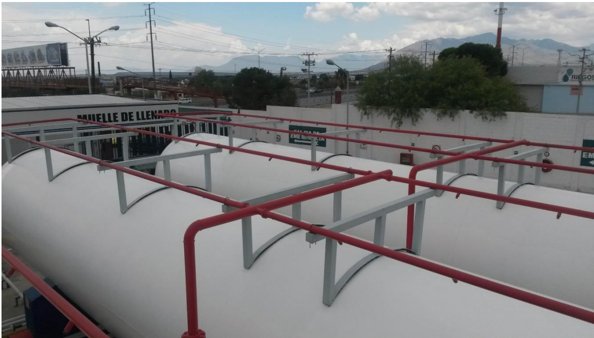
Imagen 10. 2 tanques de 110,000 y 1 de 45,240 Lts.
