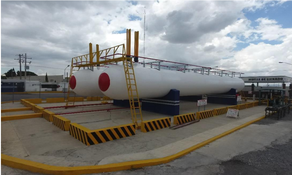
Imagen 14. Tanques de almacenamiento.
