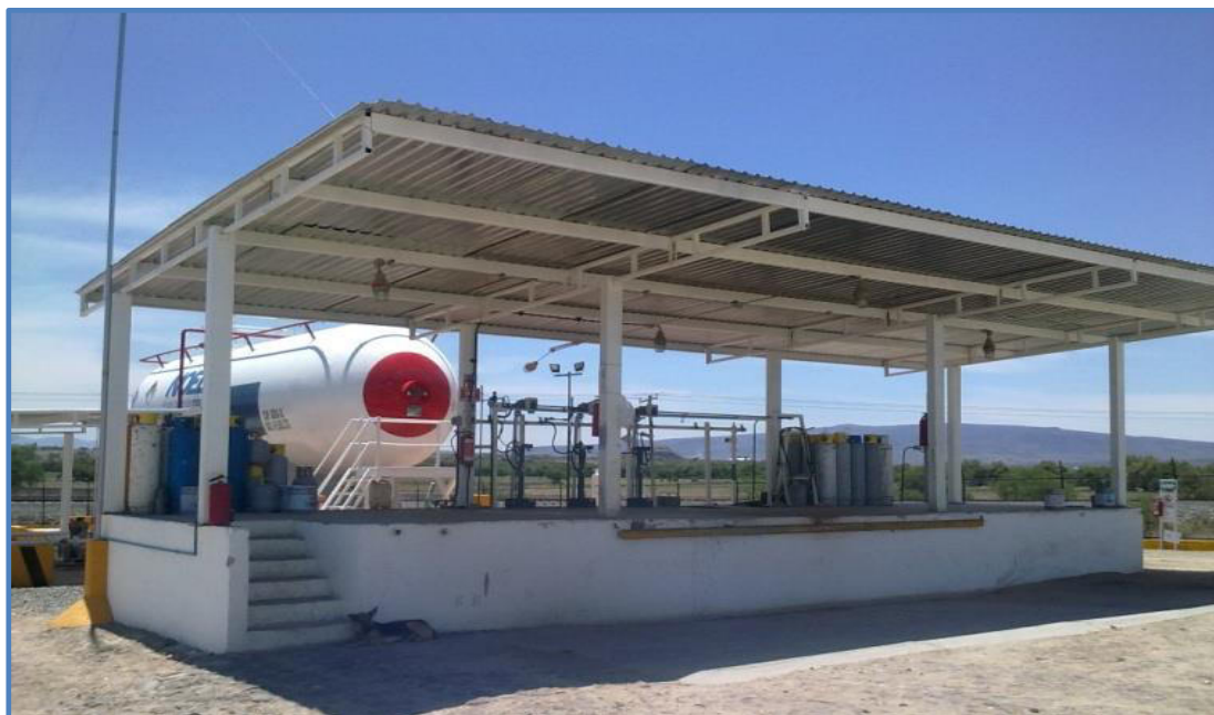
Figura II.2.5. Tanque de Almacenamiento para el Gas L.P.
