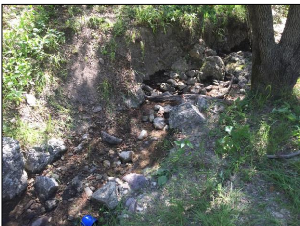
05 - El suelo afectado presenta una textura de tipo limosa con material consolidado, además de presentar distintas infiltraciones que van desde baja, baja media y media.
