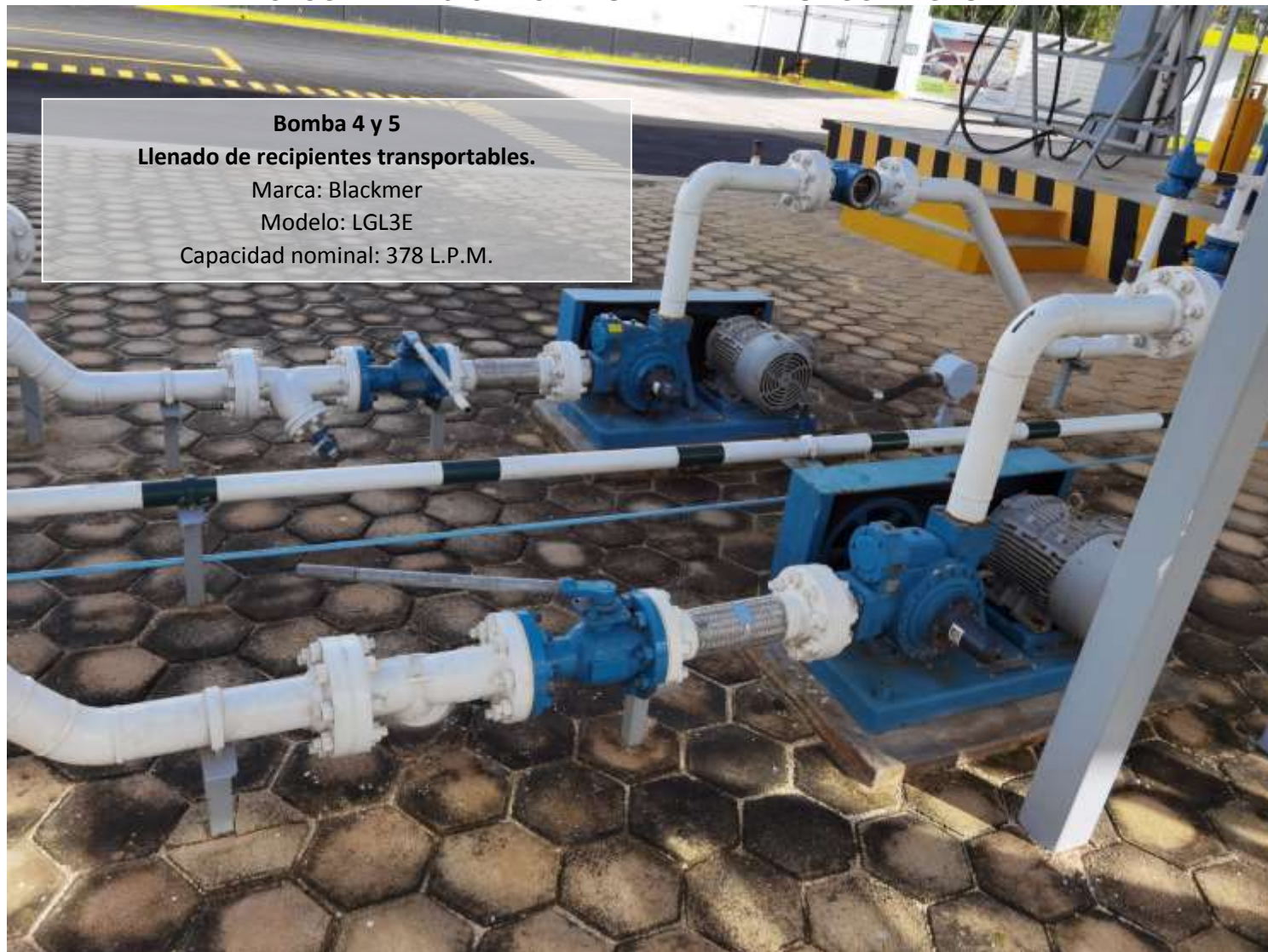
FOTOGRAFÍA No. 8 – BOMBAS PARA EL TRASIEGO DE GAS L.P.
