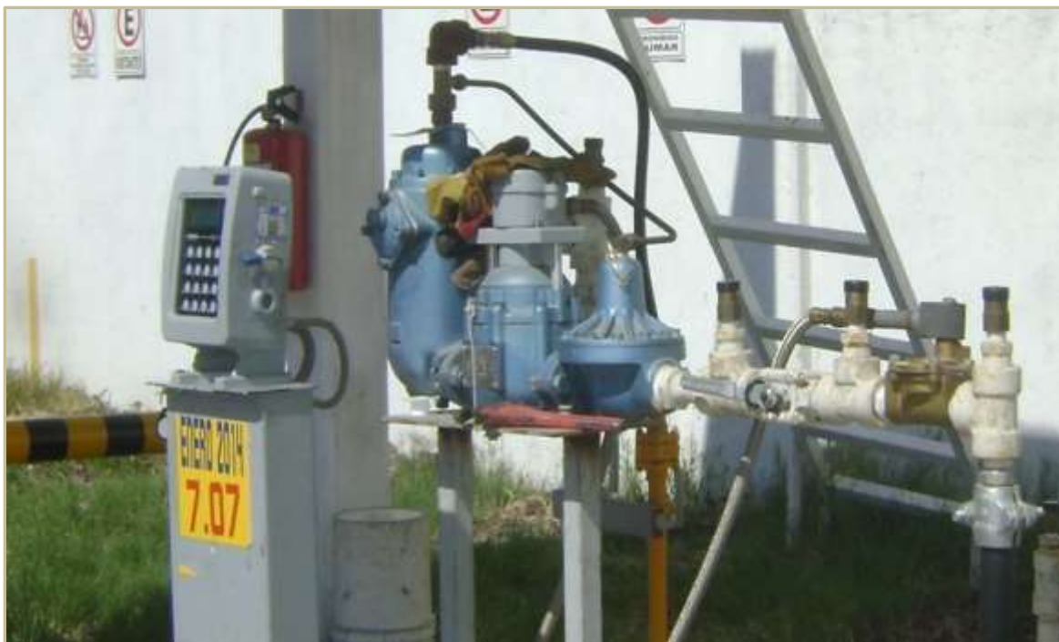
Figura III.1.c)-1. Dispensario doble para el Gas L.P.
