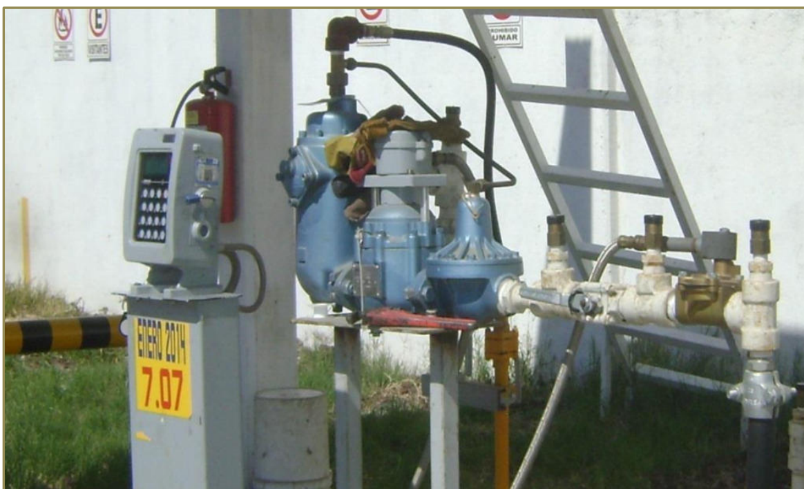
Figura III.1.c)-1. Dispensario doble para el Gas L.P.
