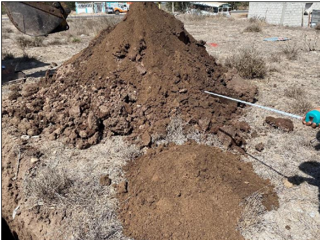
Fotografía 14. Material encontrado en el PCA #2.
