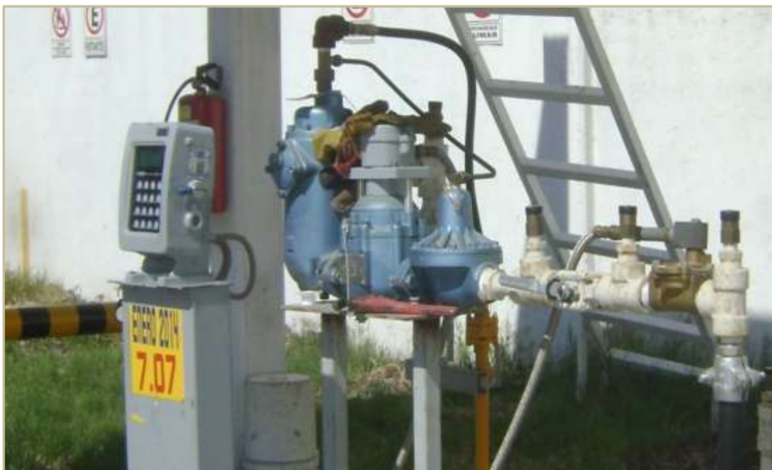
Figura III.1.c)-1. Dispensario doble para el Gas L.P.
