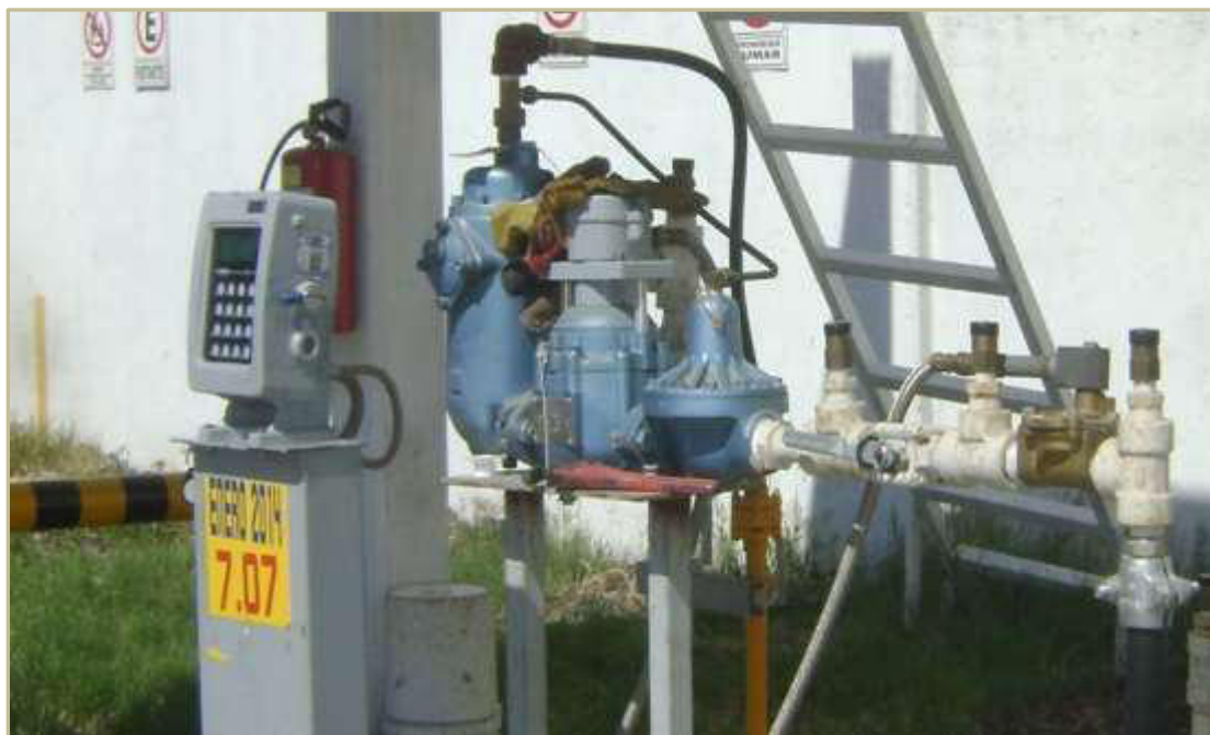
Figura III.1.c)-1. Dispensario doble para el Gas L.P.
