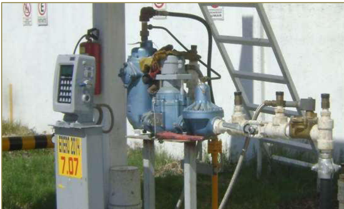
Figura III.1.c)-1. Dispensario doble para el Gas L.P.
