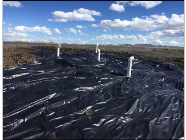
8. Área afectada sometida a emergencia, colocación de filtros de carbón y película de polietileno.
