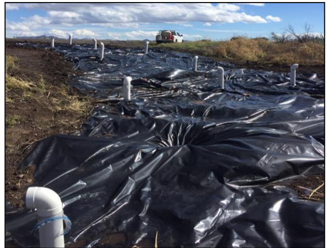
10. Vista del área sometida a labores de emergencia.
