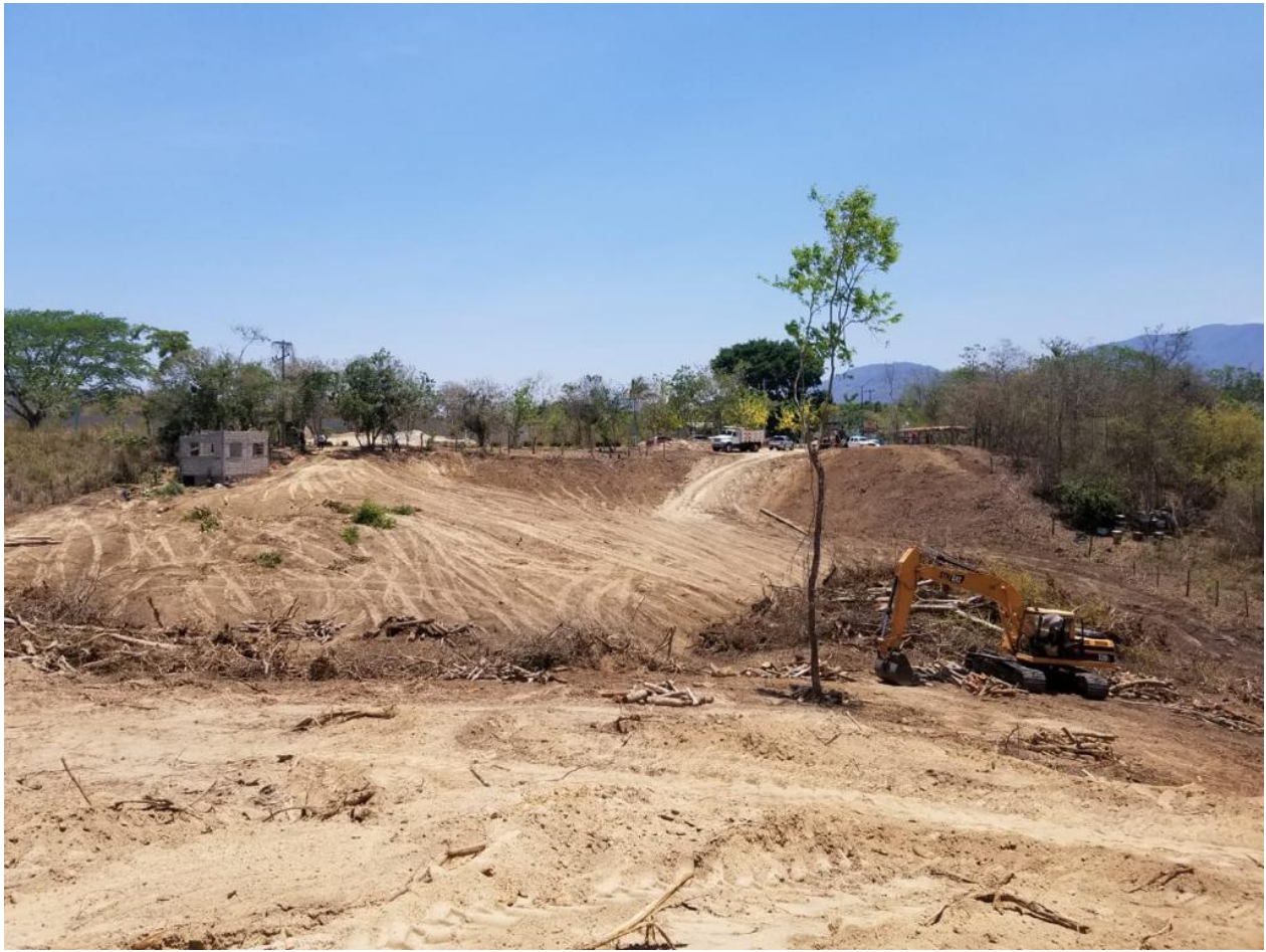
Fotografías 2.- El predio está cercado con alambre de púas en toda la periferia, cuneta con una construcción de concreto que en años anteriores fue utilizado como vivienda.
