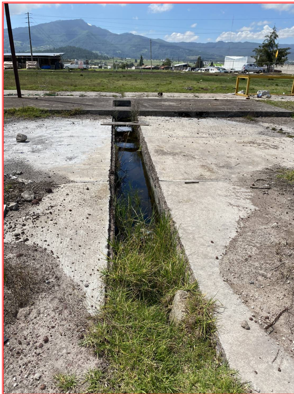
Imagen No. 11 Fotografías donde actualmente se observa que el predio cuenta con una trinchera en malas condiciones.
