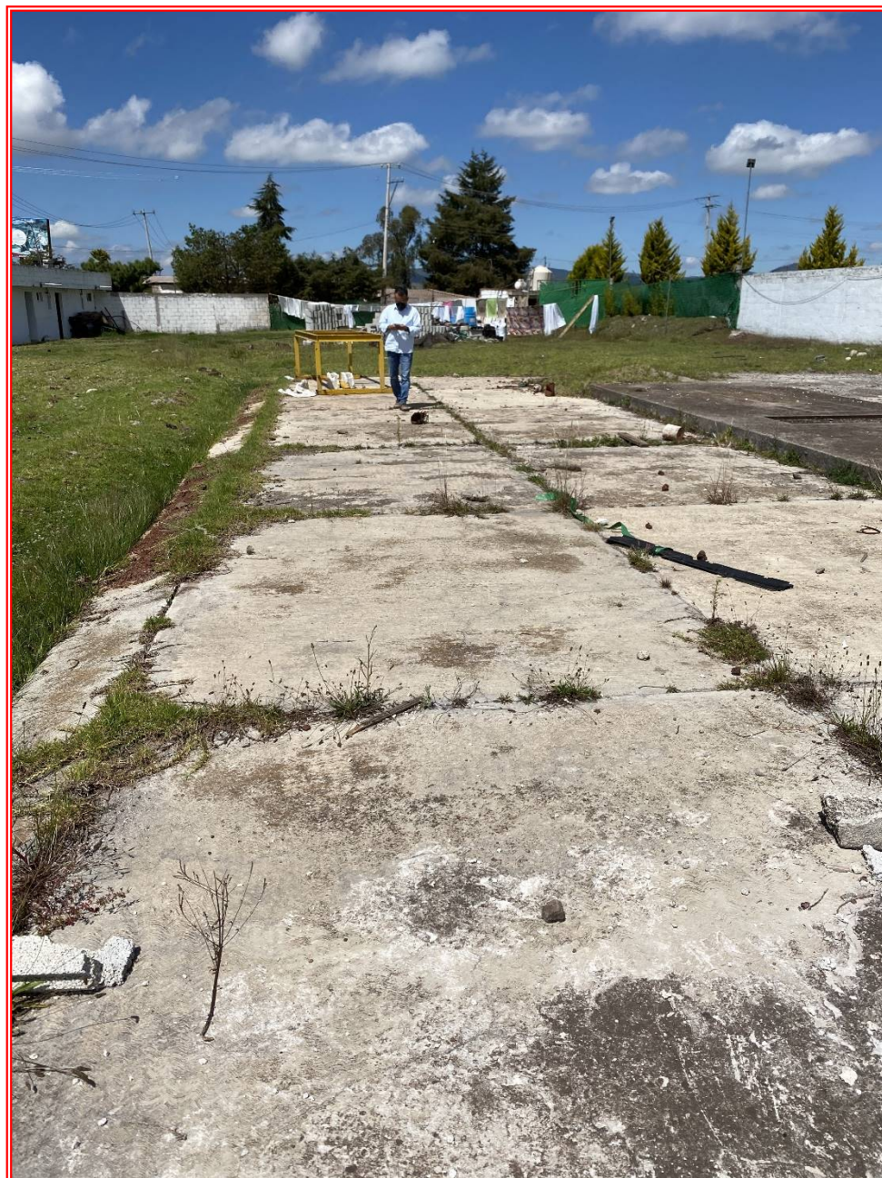
Imagen No. 8 Fotografías donde actualmente se ve que el predio cuenta con una plancha de concreto, la cual esta vieja y descuidada.
