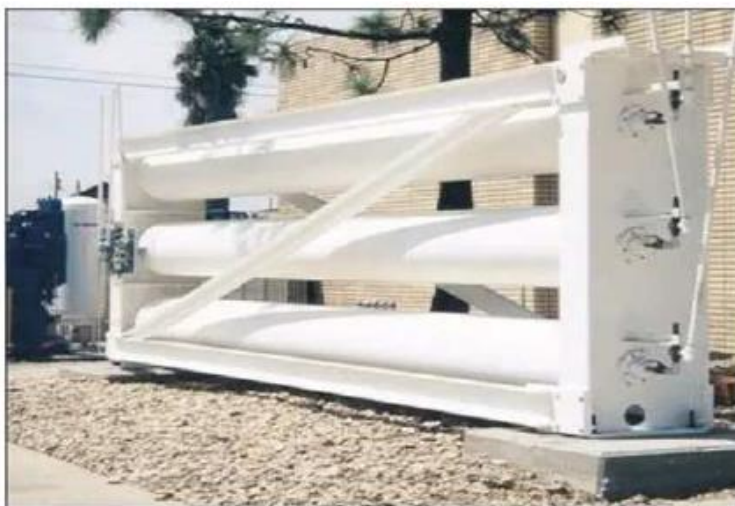
Figura II.16 Sistema de Almacenamiento
