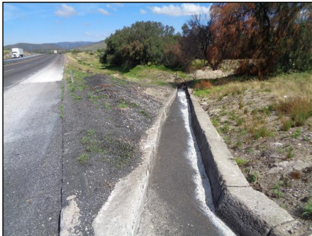
3.- Canaleta por donde se desplazó la Gasolina.
