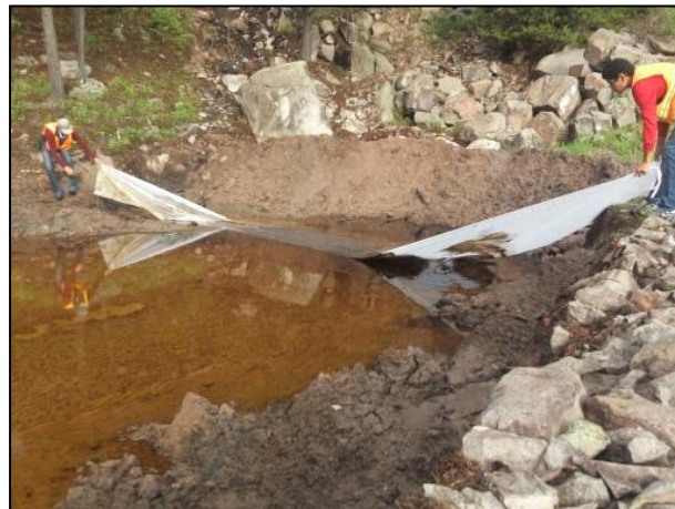
2.- Colocación de tapetes absorbentes en el cauce del arroyo que fue afectado por el derrame de Diésel.
