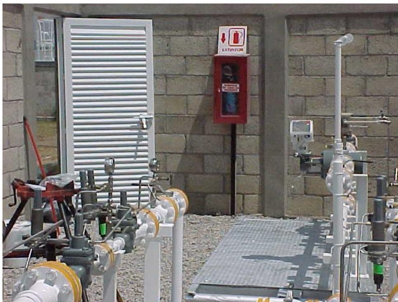
FIGURA 20. EXTINTOR TIPO ABC EN ESTACIÓN DE REGULACIÓN Y MEDICIÓN
