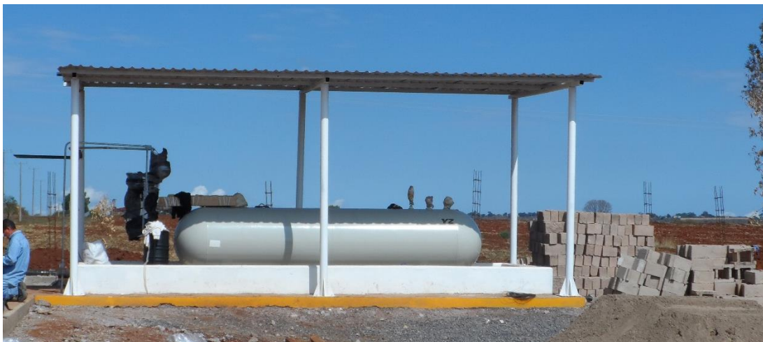
Ilustración 5. Ejemplo de sistema de odorización (fuente Compañía Mexicana de Gas)
