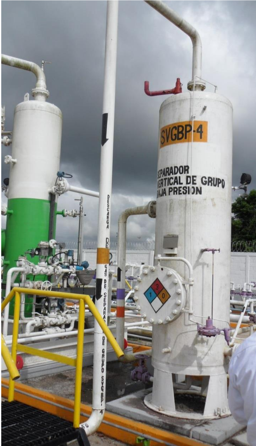
Figura 8.1-4 Separador Vertical de grupo de la Batería Ogarrío 2.
