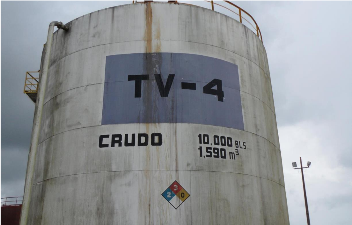
Figura 8.1-5 Tanque de almacenamiento de crudo TV-4 de la Batería Ogarrío 2.
