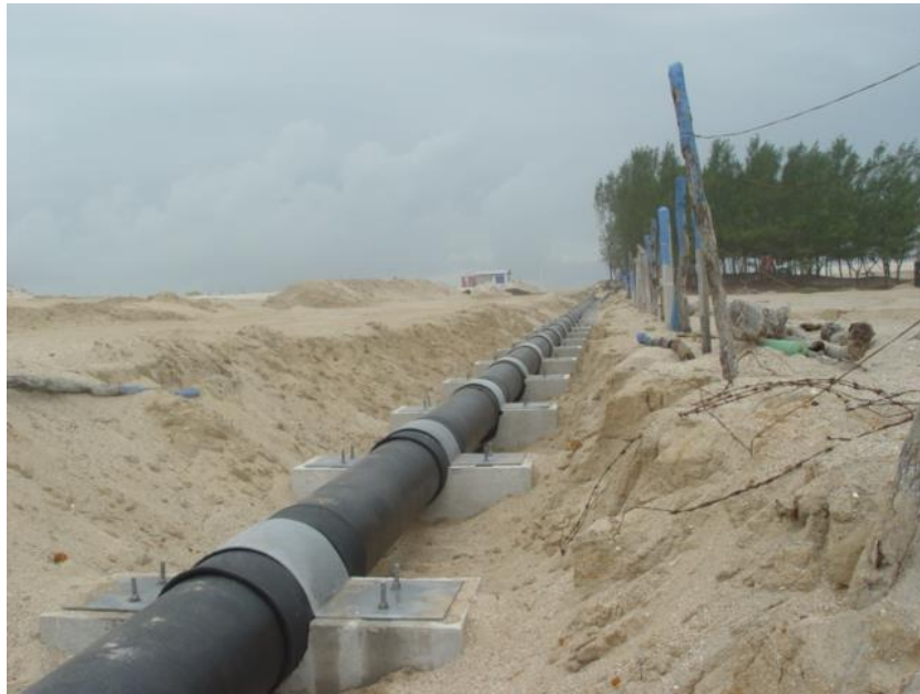
Figura I. 5 Ejemplo de Soportes de concreto en la playa
