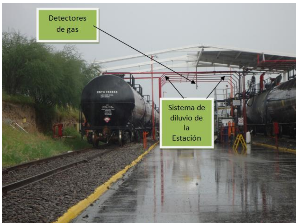
Figura 10. Ejemplo de Estación equipada para trasvase de combustibles líquidos.
