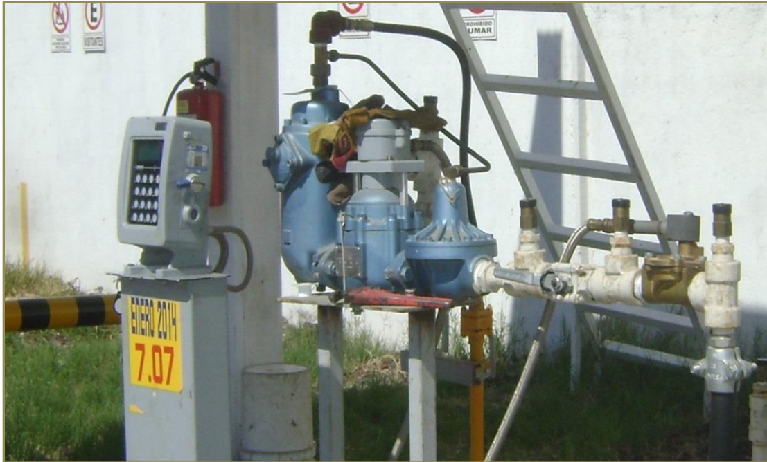
Figura III.1.c)-1. Dispensario doble para el Gas L.P.
