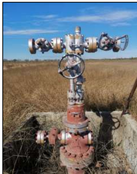
Figura 11. Mantenimiento a conexiones superficiales del Pozo Treviño 149
