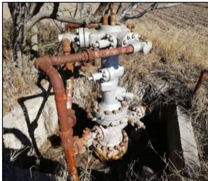
Figura 11. Mantenimiento a conexiones superficiales del Pozo Treviño 417
